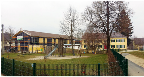
Umbau der Kinderkrippe und Neubau des Kindergartens und Kinderhorts der Stadt Laufen
